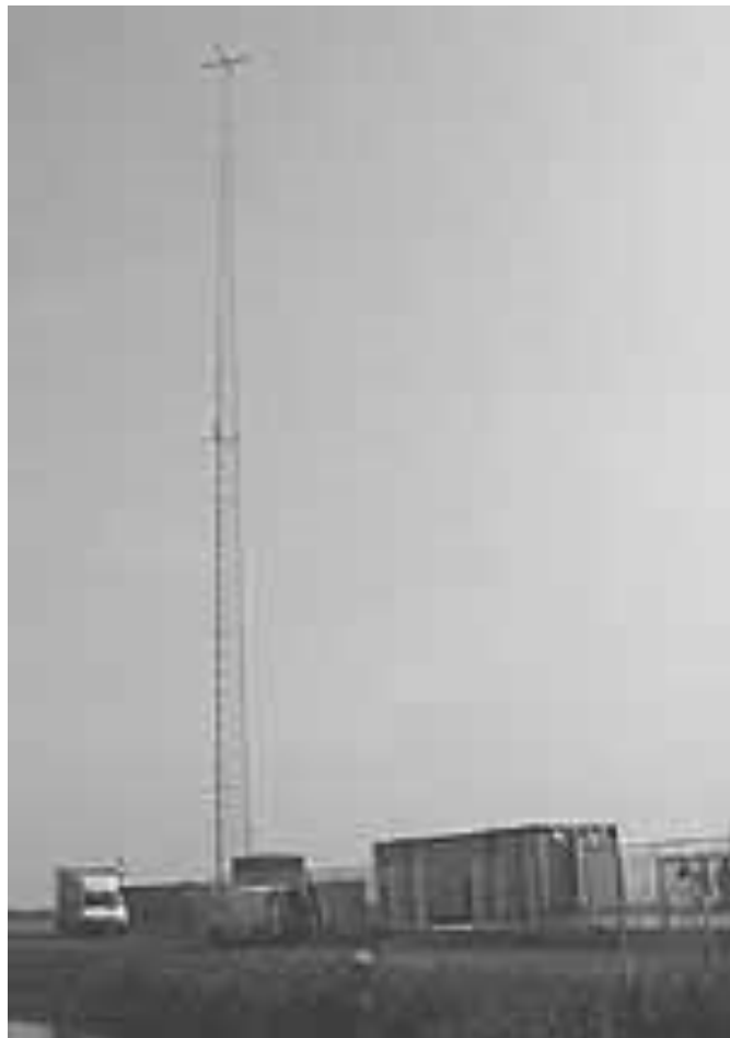
Her ses senderinstallationerne på 1395 kHz i Trintelhaven, der sender højst med 20kW.
